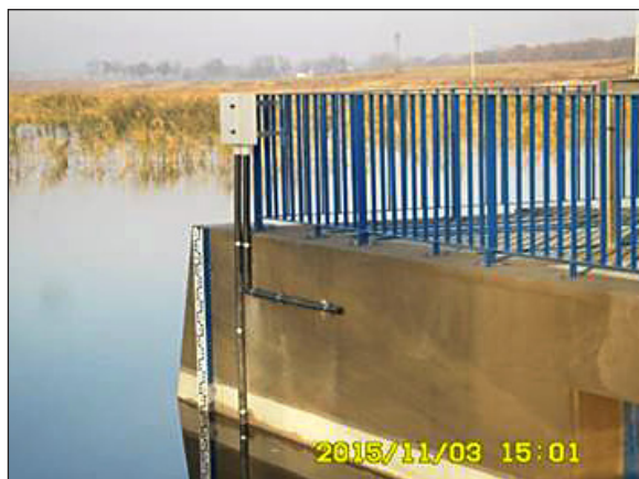
Rys. 2. Łata wodowskazowa usytuowana na urządzeniu piętrzącym zlokalizowanym na odpływie ze zbiornika
