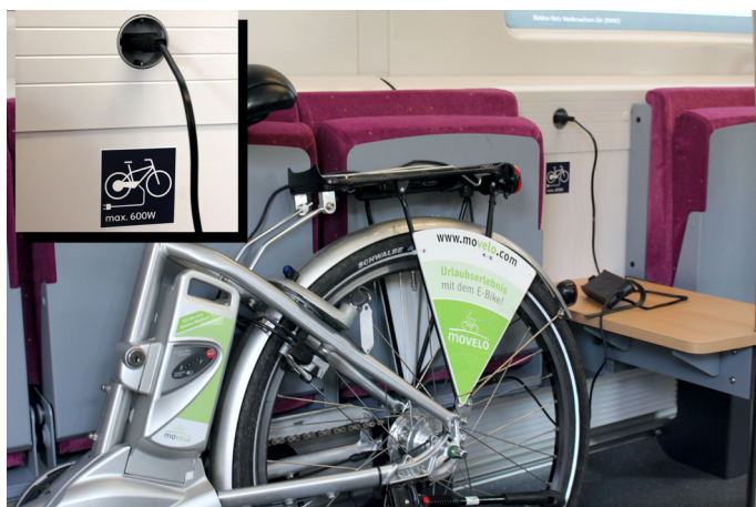
Fot. 12. Gniazdo do ładowania rowerów elektrycznych pozwala na podłączenie urządzeń o mocy znamionowej 600 W, co umożliwia ładowanie większości dostępnych na rynku rowerów elektrycznych (pociąg ENNO Metronom). Fot. Michał Beim
