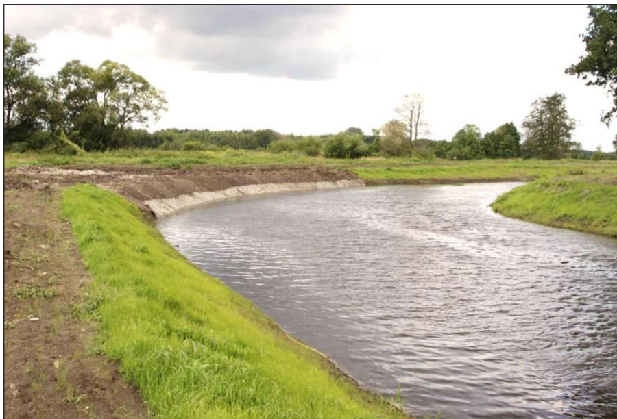
Fot. 1. Rzeka Ina – w trakcie prac polegających na stabilizacji przepływu wraz z jej odcinkową odbudową
