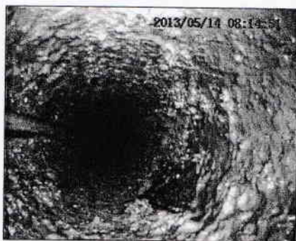
Rys. 7. Przykład niepoprawnie oczyszczonego wodociągu (ulica Przemysłowa w Poznaniu) (foto: J. Wiernicki) Fig. 7. Example of improperly purified water supply (Przemysłowa street in Poznan) (foto: J. Wiernicki)
