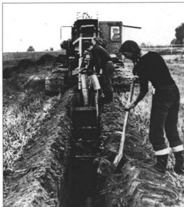
Fot. 5. Obsypywanie rurociągu drenarskiego warstwą próchniczną – tzw. „dekowanie” (archiwum IM, KSiG UP w Poznaniu)
