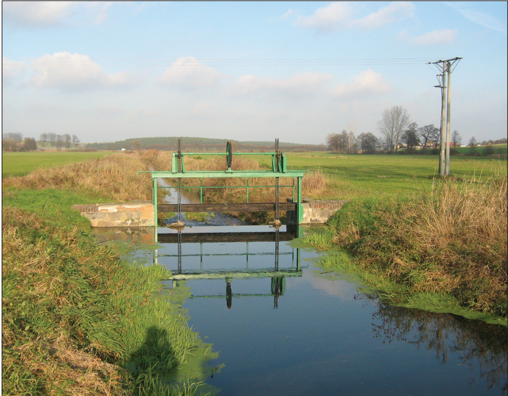
Fot. 4. Jaz piętrzący wodę w Kani w km 1 + 274 (wysokość maksymalnego piętrzenia 0,85 m)
